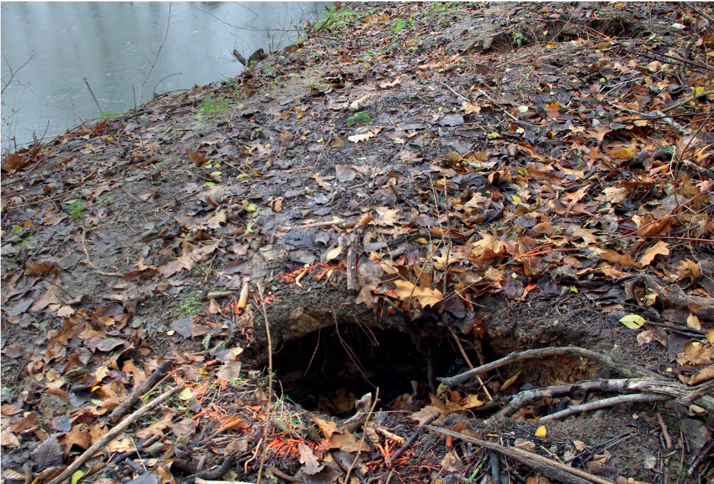
Hráze rybníků poškozené norami bobrů patří mezi nejzávažnější konflikty. Foto Jitka Uhlíková
