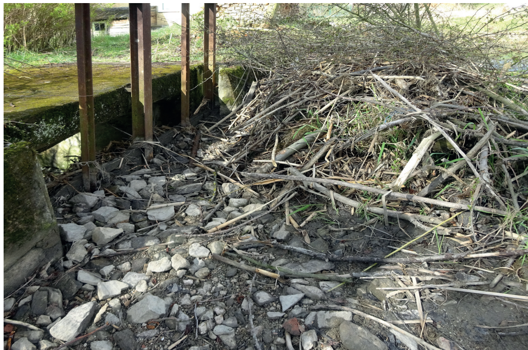
Dalším problémem, který bobr na rybnících způsobuje, je jím ucpaný bezpečnostní přeliv. Foto Jitka Uhlíková
