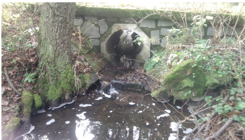
Obr. 4: Jeden z propustků na Ranském potoce s nízkým betonovým stupněm (cca 12 cm). Foto J. Matrková, 11. 11. 2022
