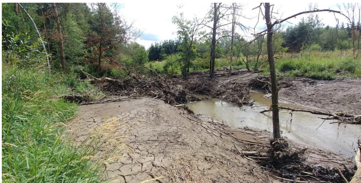
Obr. 48: fotografie vypuštěné zdrže hráze č. 5, k jejímuž protržení došlo při povodni 27.6.2024
